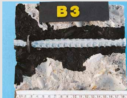
... ja vesitiiveysvälikkeiden ympärillä ovat aiheuttaneet vuodon.
